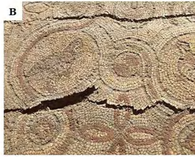
VIII no.lu pano üzerindeki çatlak alanlar detay görünüm.
