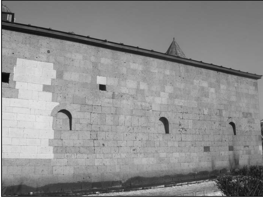
Resim 10: Erzurum Yakutiye Medresesi, güney cephe duvar dibindeki drenaj ve çatı sisteminden kaynaklanan bozulma
