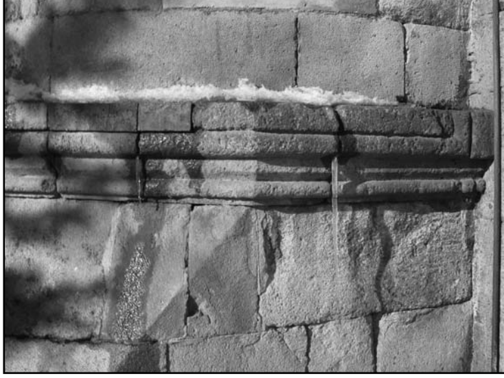
Resim 9: Erzurum Yakutiye Medresesi, minare kaidesinde derz boşalması
