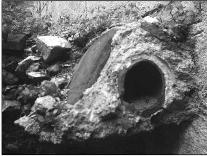
Resim 8: Ayasofya'nın kuzey bahçesindeki parçalanmış su boruları
