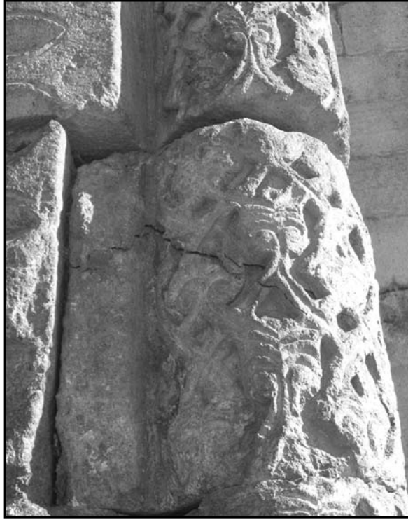
Resim 6: Erzurum Yakutiye Medresesi, portaldeki köşe sütuncesindeki çatlak
