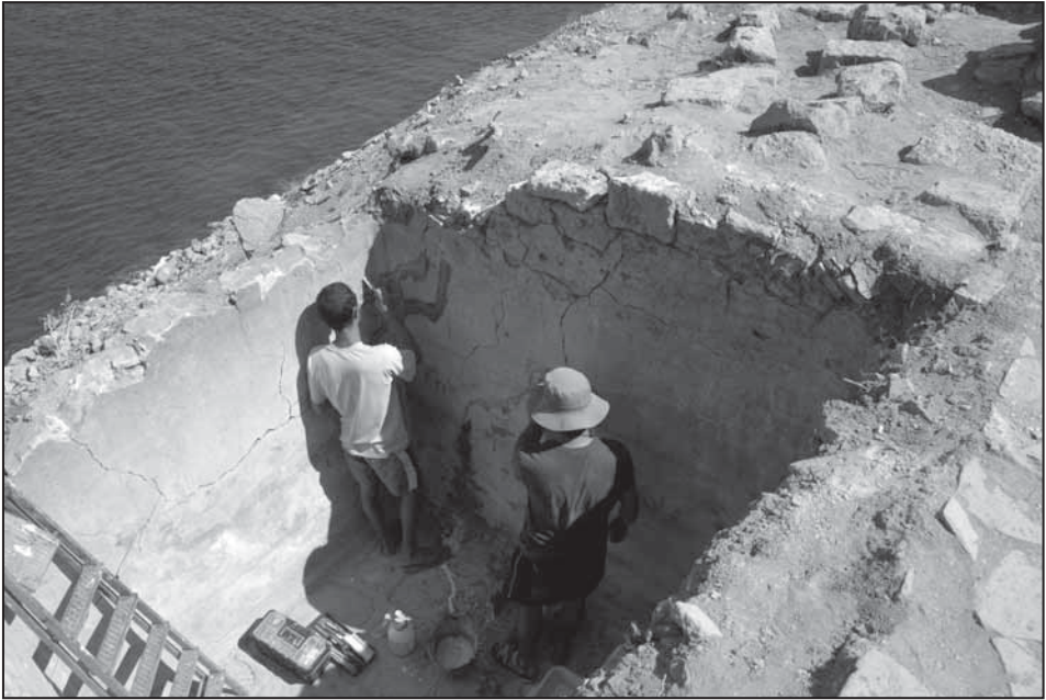
Resim 11: Sarnıç içlerinde sıvalarda oluşan çatlaklar kapatılırken.
