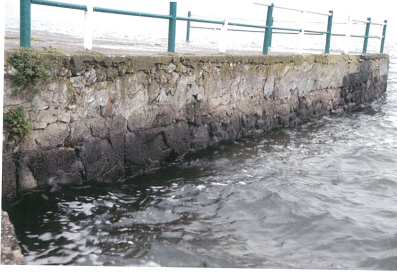
Resim 23. Seyir terasının oturduğu platformun temel taş sırası antik dönem duvarları ile benzerlik göstermektedir.
